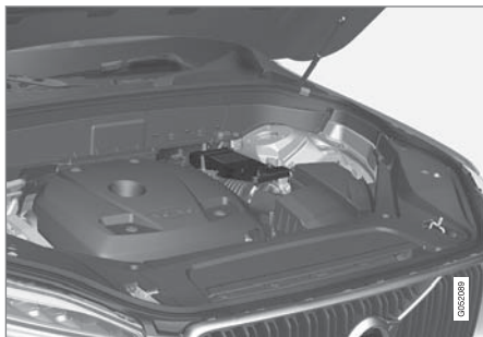
辅助蓄电池位于靠近上拉杆的箱体中。
